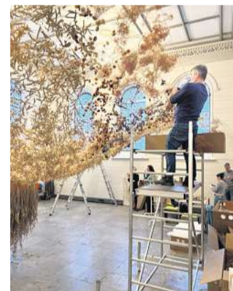
Von einer Arbeitsbühne aus werden die Pflanzen in der ehemaligen Synagoge aufgehängt.
